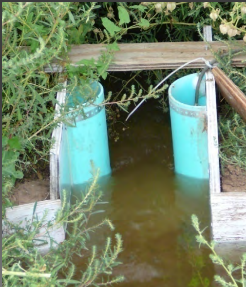
S-M flow meter
